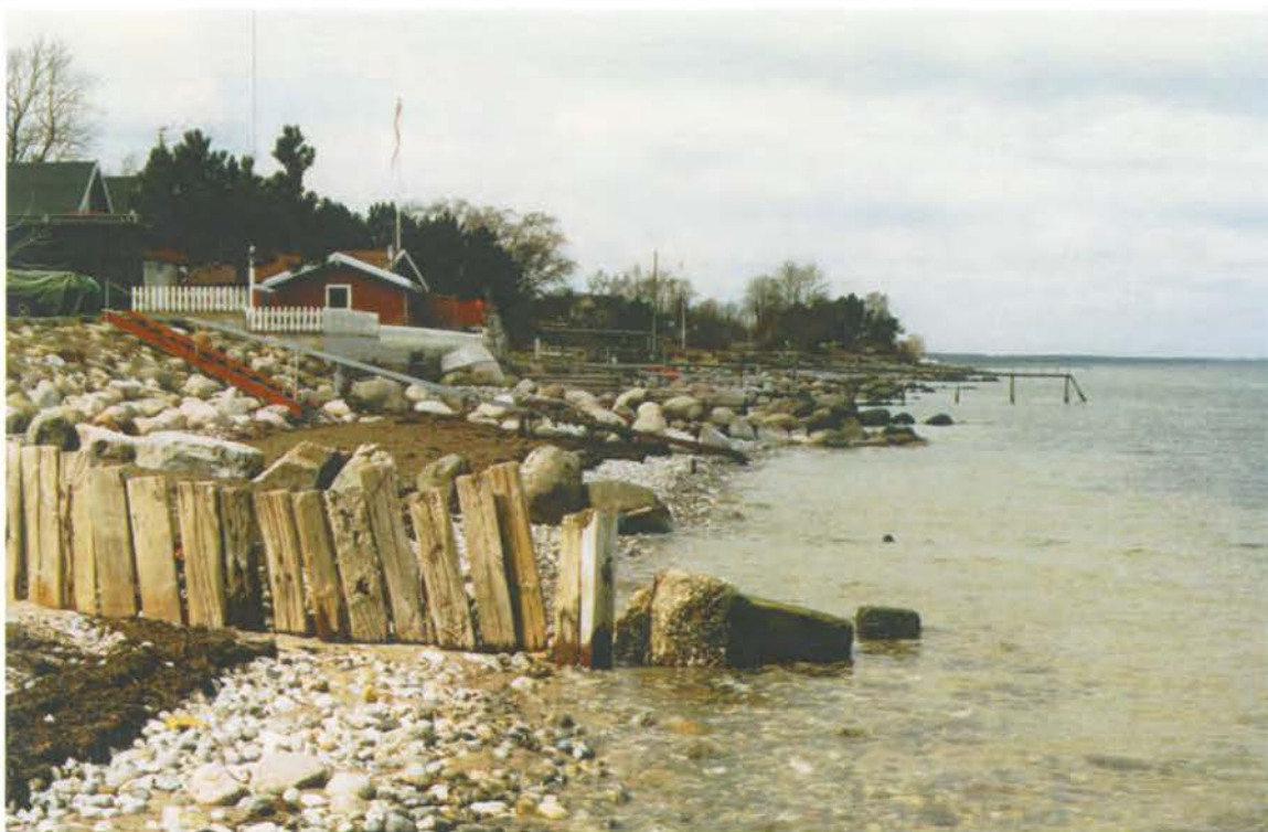
Foto 21: Jernbanesvellerne i hofden står ikke tæt længere, materiale har derved mulighed for at trænge igennem. Høfderne er korte og når ikke langt ud i vandet.
