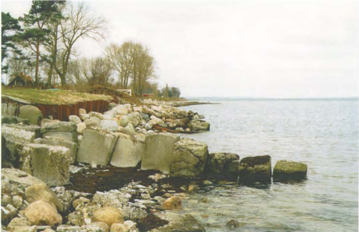
Foto 11: Nedrammede spunsjern, betonklodser og sten mere eller mindre tilfældigt placeret er ved Strøby Ladeplads anvendt som kystbeskyttelse.
