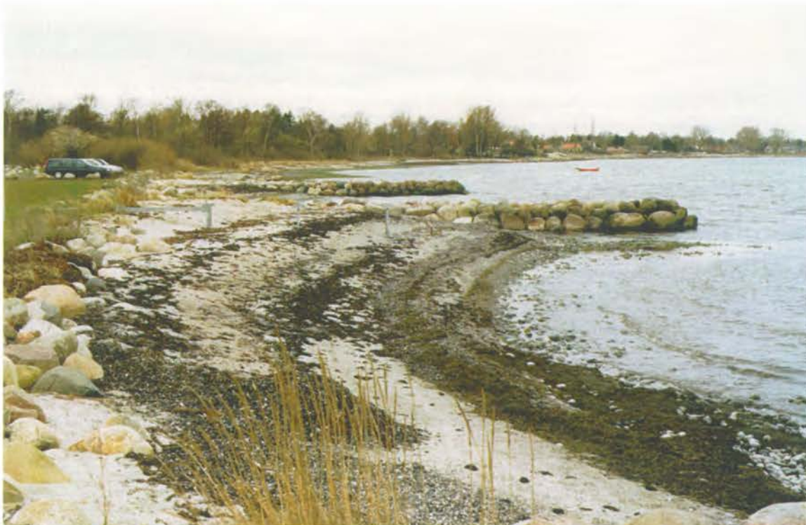
Foto 5: Ved st. 800-1050 er etableret fem høfder; kysten ses at have dannet luvsideaflejring og læsideerosion. Det bagvedliggende land er beskyttet ved en skråningsbeskyttelse af større sten. P- pladsen ses i baggrunden.
