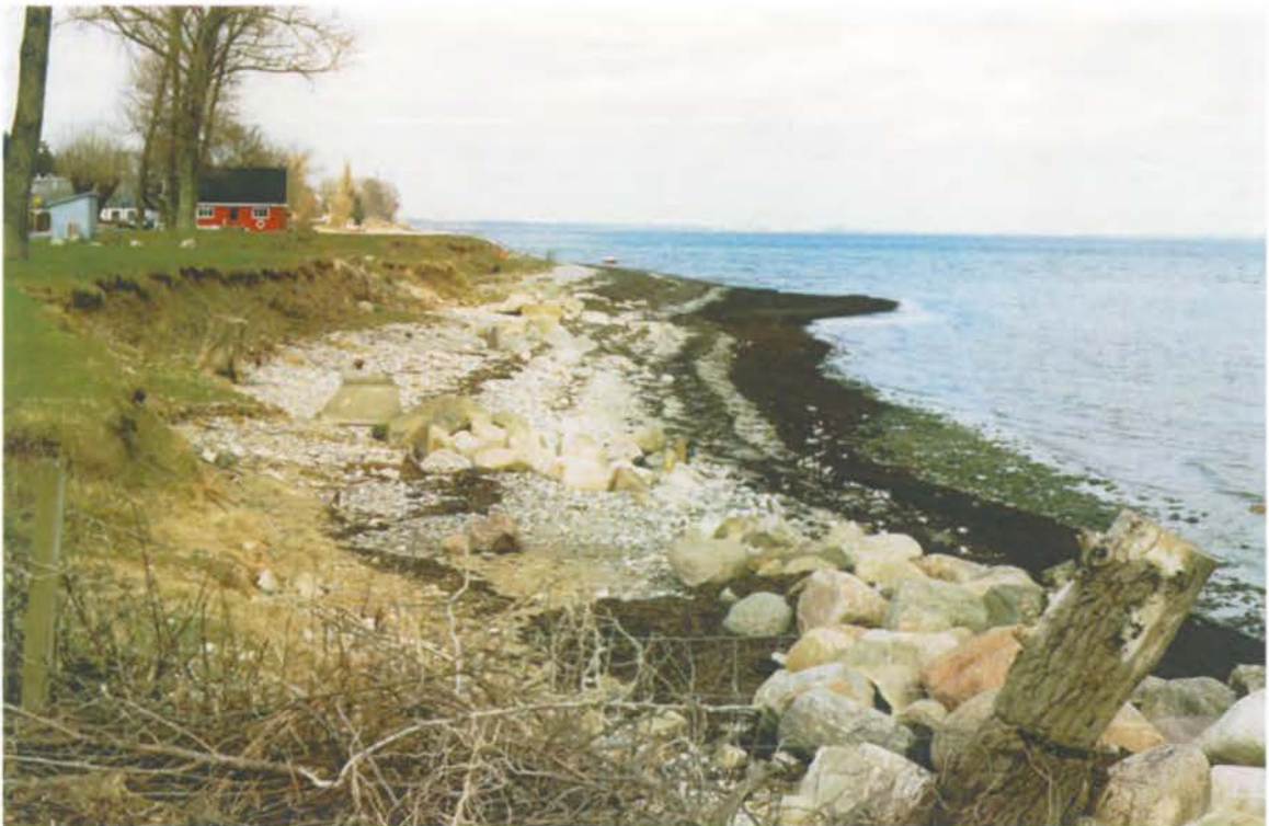
Foto 12: Ved bølgebryderen er der aflejret materiale på kysten. Skråningen mod det bagvedliggende terræn ses at være eroderet af bølger og strøm. Som så mange andre steder ser det ud til at være tilført fyldjord, som der er eroderet i.
