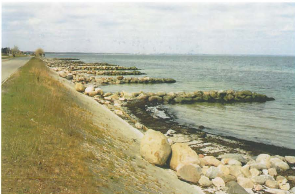
Foto 18: Kystvejen ligger helt ud til kysten på en del af den 1 km lange strækning fra st. 2500-3500. Vejen er sikret mod erosion, her med SF-sten på skråningen andre steder med sten ovenpå SF-sten.
