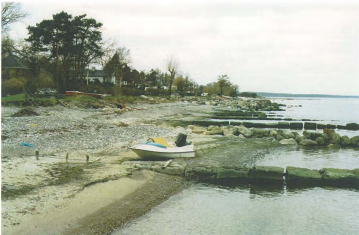
Foto 28: Høfder af betonklodser er flere steder udlagt som kystbeskyttelse, som her ved st. 4450. Sedimenter på stranden har mulighed for at passere over konstruktionen. En lav erosionsbrink ses ind mod baglandet.
