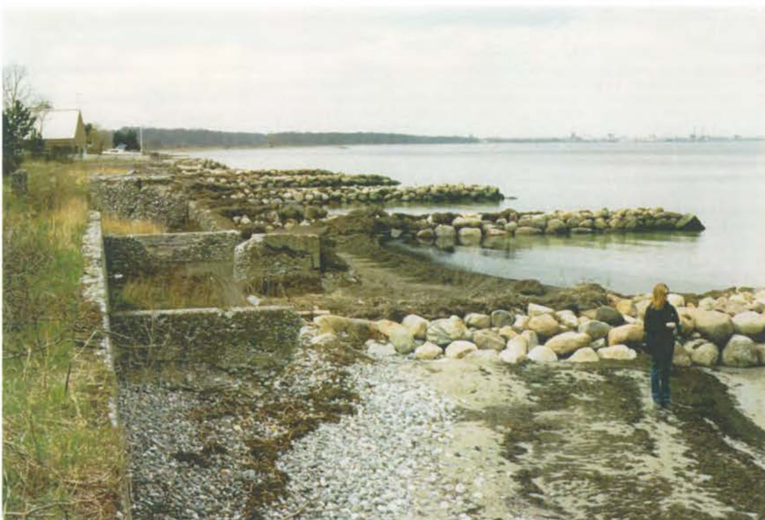
Foto 38: Ved st. 6500 og et par hundrede meter mod vest er baglandet beskyttet mod erosion af en murkonstruktion og kraftige stenhøfder. Generelt er der opsamlet store mængder tang på denne strækning. Muren bør fjernes og høfderne ombygges.
