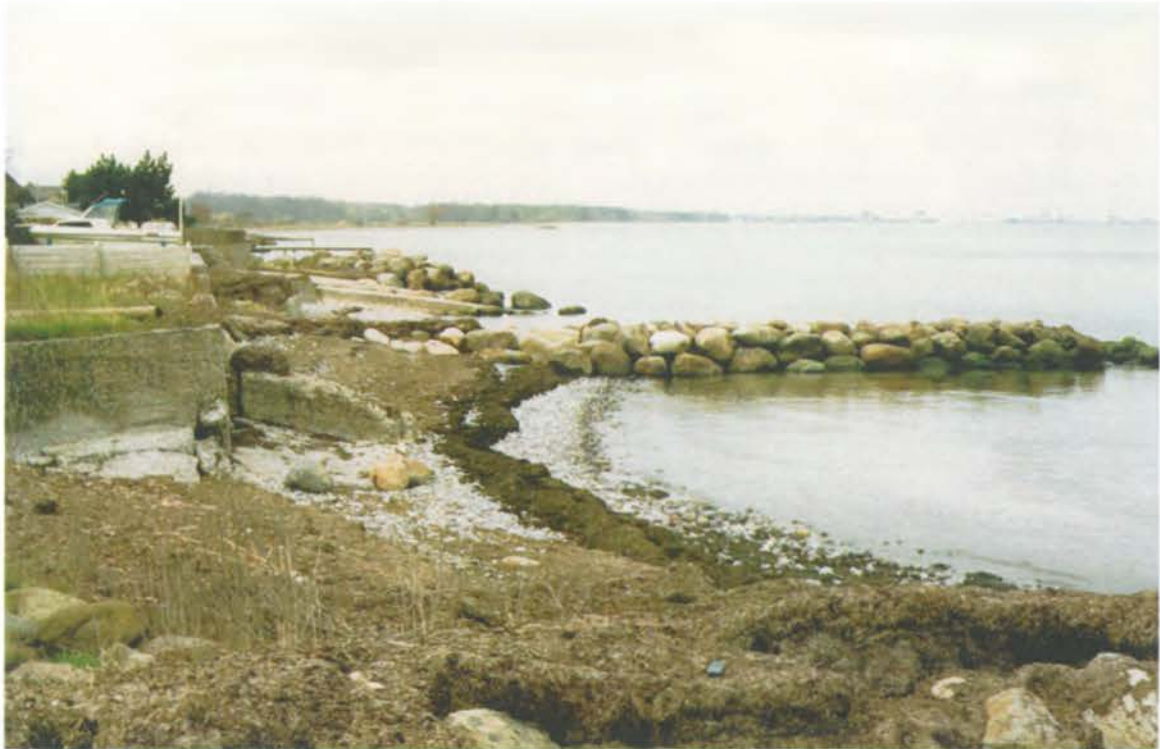
Foto 39: Vest for st. 6600 ligger konstruktionerne tæt, og tang, båderamper, brokker mv. hindrer passage-mulighederne.
