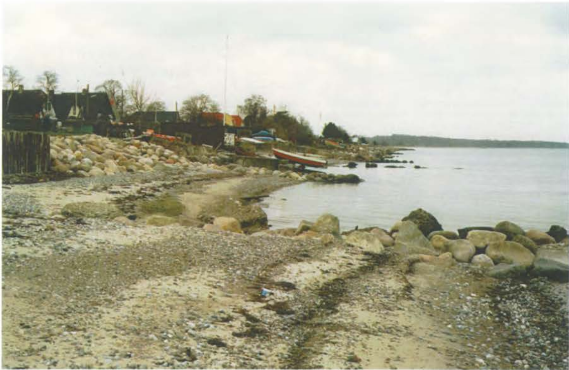
Foto 35: De større høfder kan opsamle store mængder materiale på kysten. Skråningsbeskyttelsen er en kontrast til den nærliggende mere pladskrævende naturlige strand. Foto fra Strøby Egede st. 5900.
