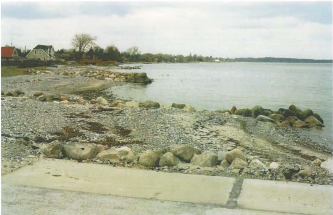
Foto 30: Vest for pynten i st. 5000 er udlagt stenhøfder på den brede forstrand. Den ene dækker over et Ø1000 udløbsrør. Høfderne anbefales bibeholdt ved ændringer i kystbeskyttelsen.
