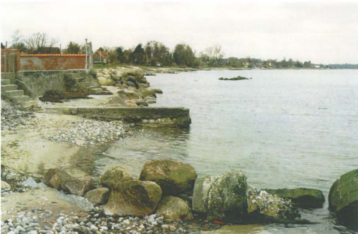
Foto 32: Ejendommen i st. 5200 er sikret mod erosion ved en betonmur. Den smalle forstrand foran muren er beskyttet med beton og sten.
