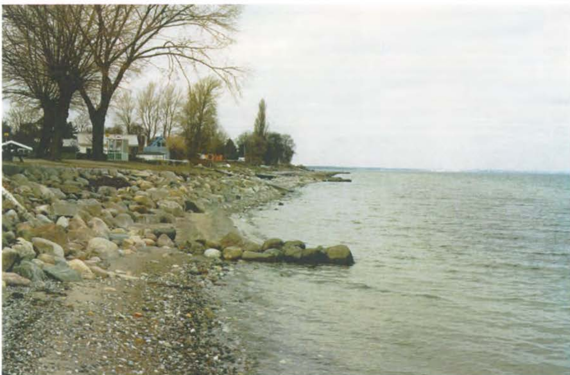
Foto 14: Fra st. 2250 og knap 200 m mod vest er skråningen sikret ved en betonmur og stenkastning. De foranliggende høfder har kun ringe effekt. Kystvejen ses (busstoppested) at ligge tæt på kysten på denne strækning.
