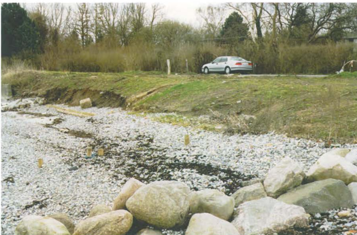
Foto 26: I st. 4200 er skråningen eroderet. Formodentlig er der lagt fyldjord på skråningen samt sået græs. Rester af parallelværker og hofder i træ vidner om tidligere tiders forsøg på beskyttelse. En opfyldning med ral vil formodentlig være relativt stabil.
